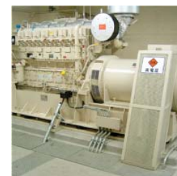
非常用発電システム
